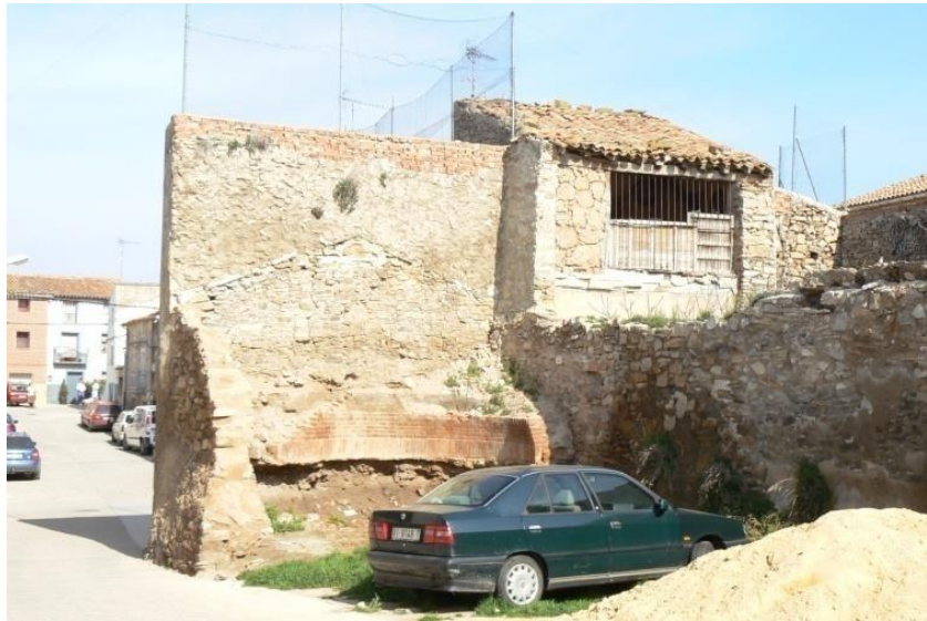
Ilustración 334. Fotografía: Horno municipal. En Inventario de los Bienes Inmuebles del Patrimonio Etnográfico , por Ángel Coronado, 2007, http://157.88.193.21/~bipe/index.php
