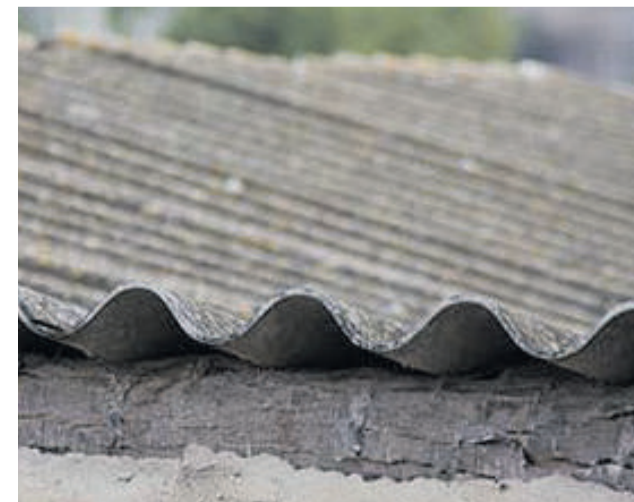
Tejado compuesto por fibrocemento con amianto.
