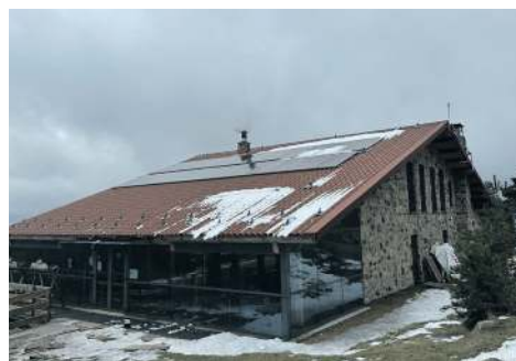
Las placas solares puestas en funcionamiento
