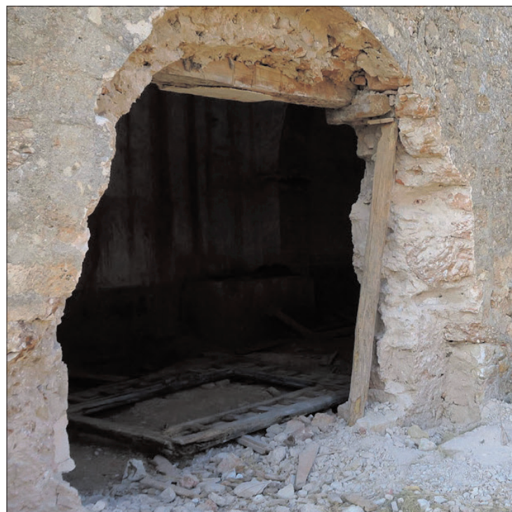
Portada de la ermita de la Mercadera, en Rioseco, completamente arrancada.
