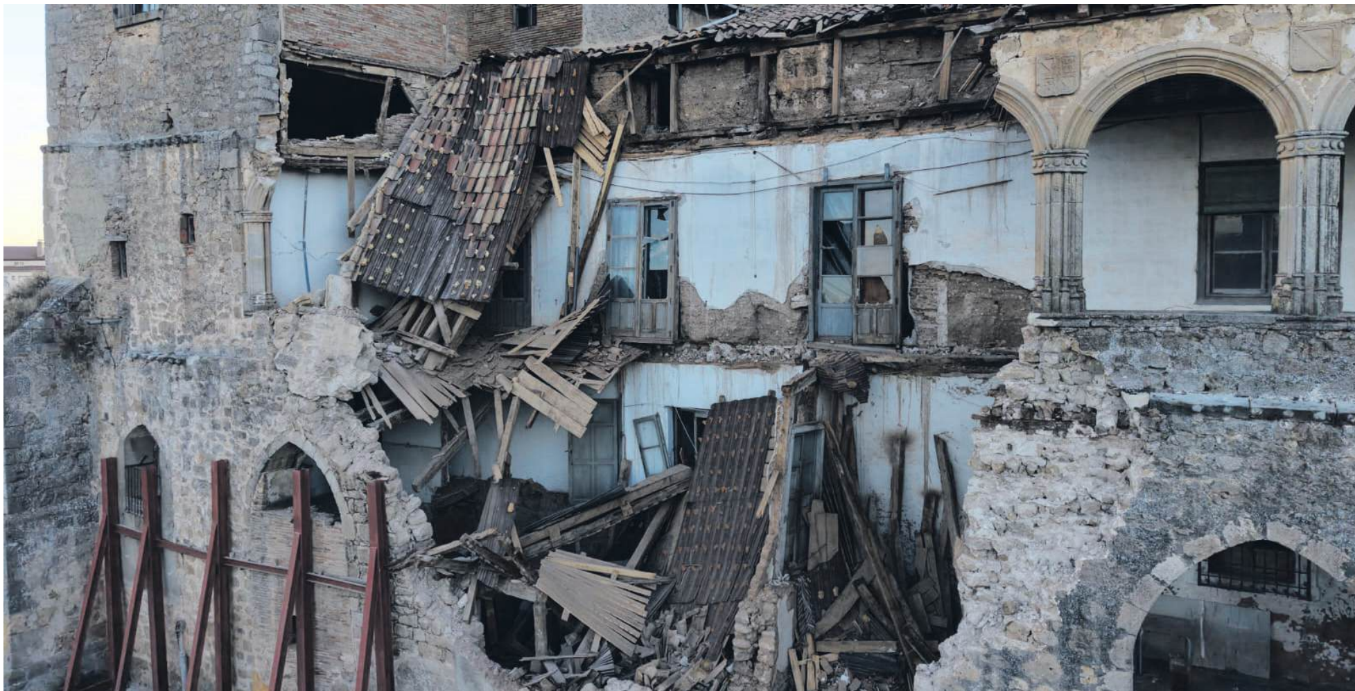
Último desprendimiento del Palacio de los Hurtado de Mendoza de Almazán.
