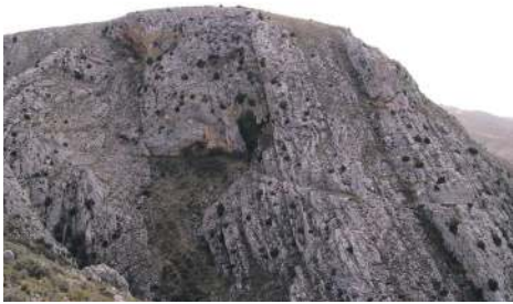
Socavón en el terreno
