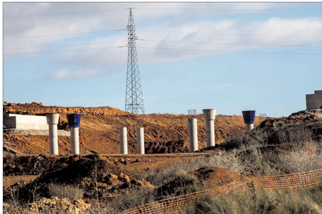
Obras de construcción de la autovía del Duero en la provincia de Soria. /s.n.
