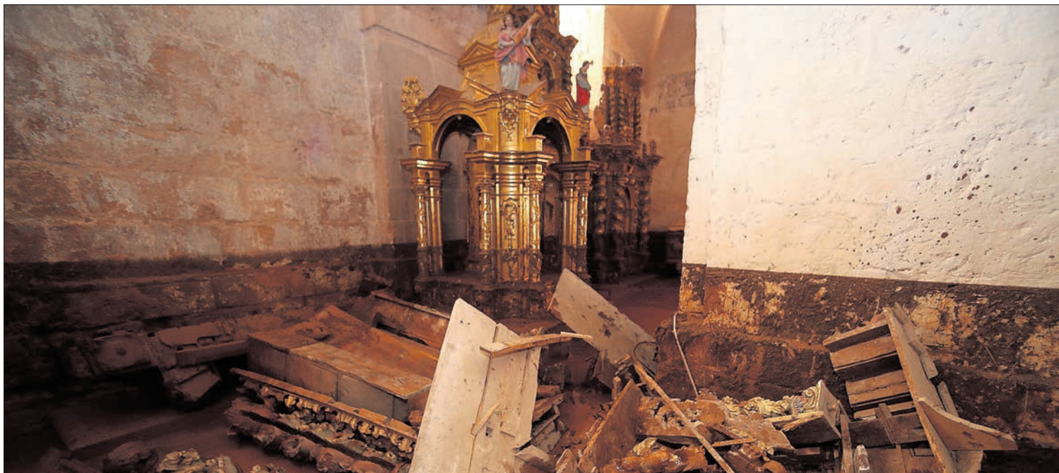
Las consecuencias de la tormenta dejaron una imagen desoladora en el Monasterio de Santa María de Huerta.
