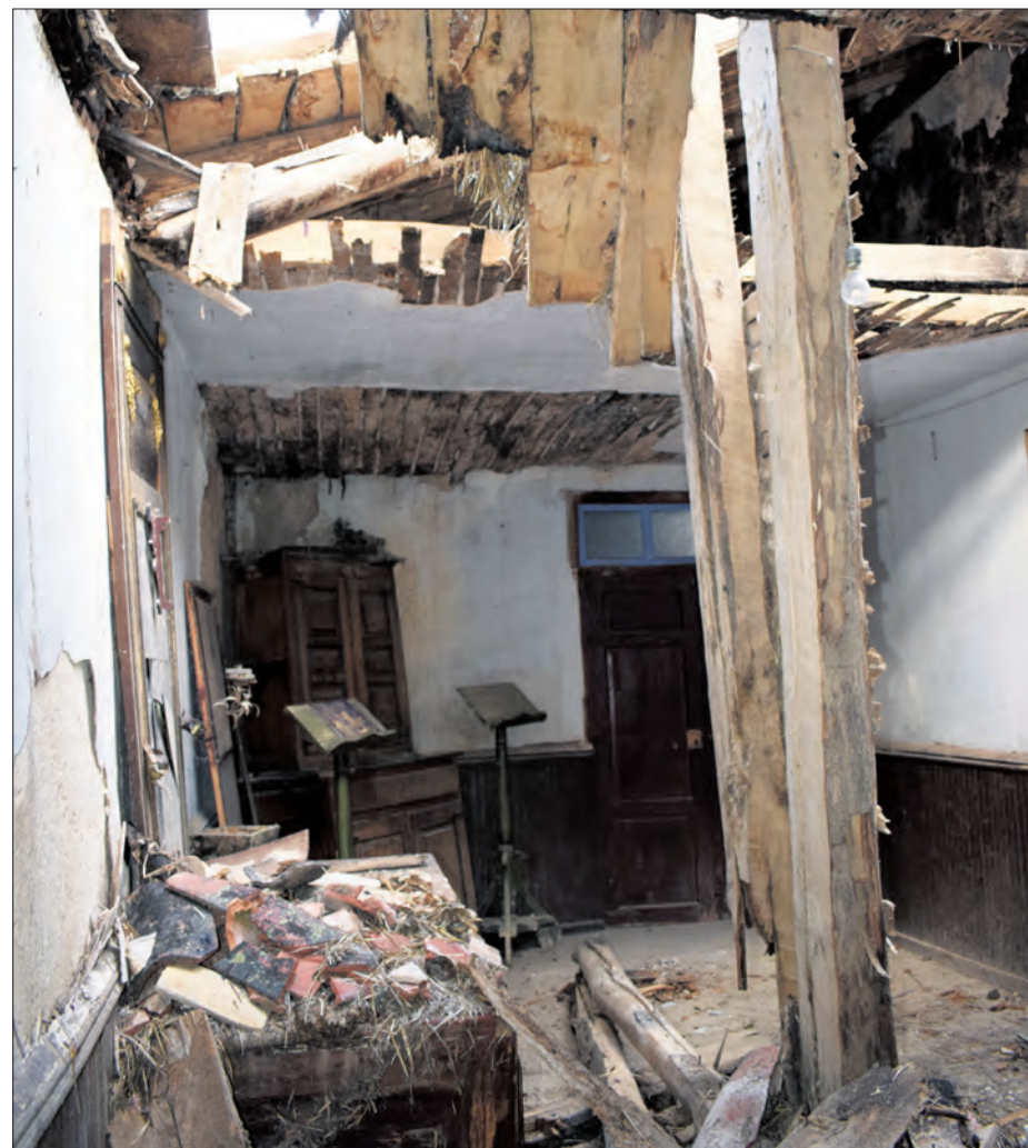
El tejado de la sacristía adyacente a la capilla se ha derrumbado. Es el paso a la sala del camarín.
